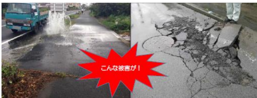
【マンホールからの下水噴出】
