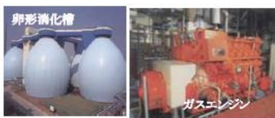
横浜市北部汚泥資源化センター 集約汚泥からのバイオガスによる発電(900kW×5台)をPFI事業(H21~H42)にて実施。
